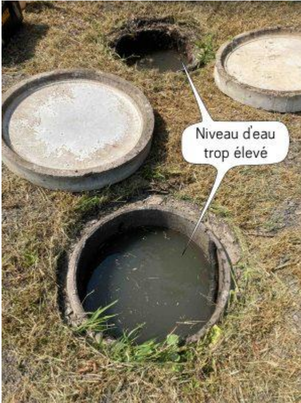
Figure 15 : Le niveau d'eau est trop élevé, on ne voit ni les tuyaux, ni le déflecteur, ni le préfiltre.
