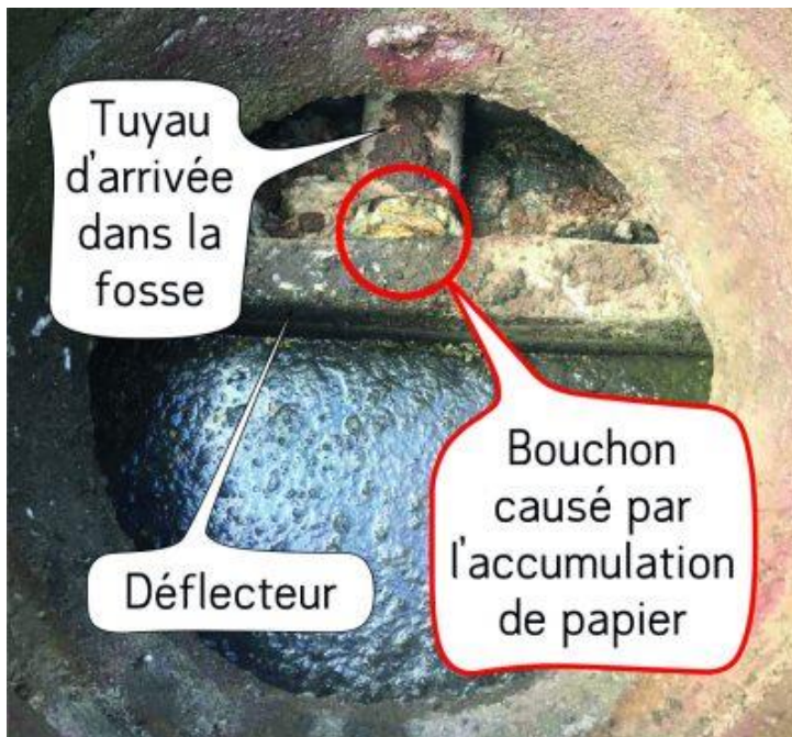
Figure 33 : Premier couvercle : bouchon causé par l'accumulation de papier au tuyau d'entrée dans la fosse.
