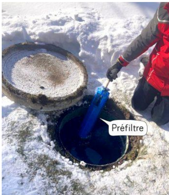
Figure 28 : Préfiltre nettoyé prêt à être remis dans son réceptacle.
