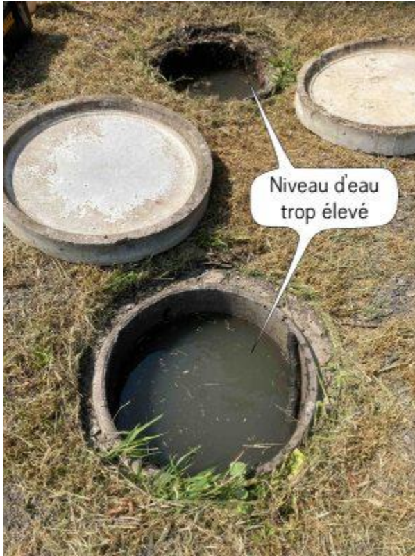
Figure 17 : Le niveau d'eau est trop élevé, on ne voit ni les tuyaux, ni le déflecteur, ni le préfiltre.
