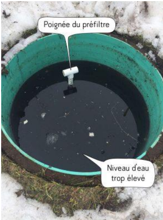
Figure 20 : Niveau d'eau trop élevé dans le deuxième couvercle, le niveau d'eau est au-dessus du tuyau de sortie vers l'élément épurateur.
