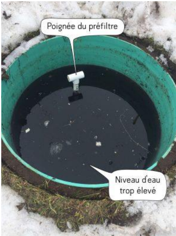
Figure 11 : Deuxième couvercle : le niveau d'eau se situe au-dessus du tuyau de sortie vers l'élément épurateur, il est donc trop élevé.
