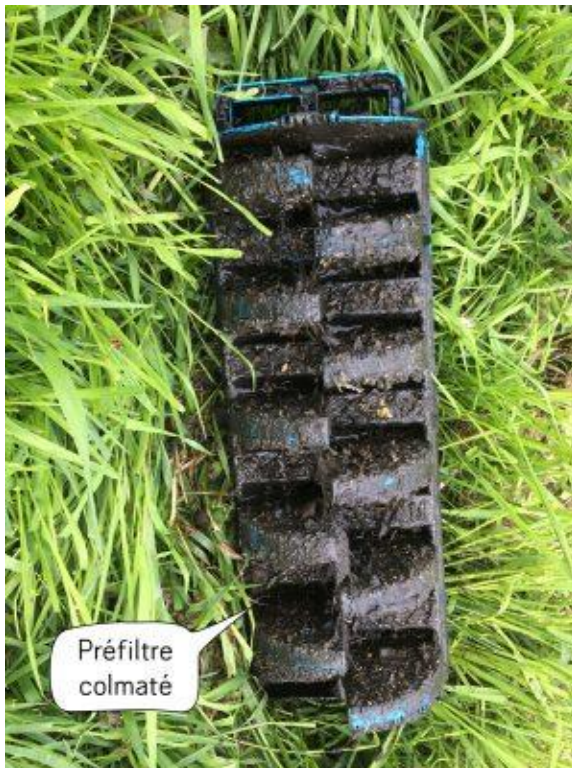
Figure 26 : Préfiltre colmaté ne laissant plus passer les eaux vers l'élément épurateur.
