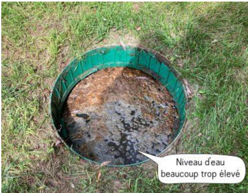
Figure 18 : Niveau d'eau trop élevé dans le premier couvercle, on ne voit ni le tuyau d'arrivée dans la fosse, ni le déflecteur.
