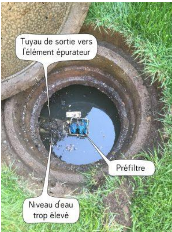
Figure 12 : Deuxième couvercle : le niveau d'eau se situe au-dessus du tuyau de sortie vers l'élément épurateur, il est donc trop élevé.
