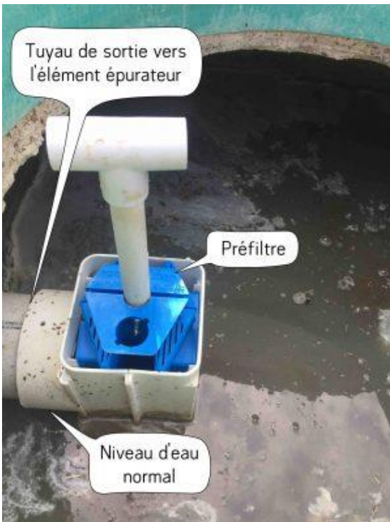
Figure 7 : Niveau d'eau normal observé dans le deuxième couvercle.
