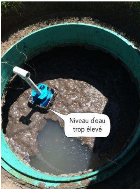
Figure 22 : Niveau d'eau trop élevé dans le deuxième couvercle, le niveau d'eau est au-dessus du tuyau de sortie vers l'élément épurateur.
