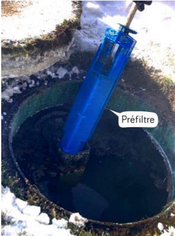
Figure 27 : Préfiltre nettoyé prêt à être remis dans son réceptacle.
