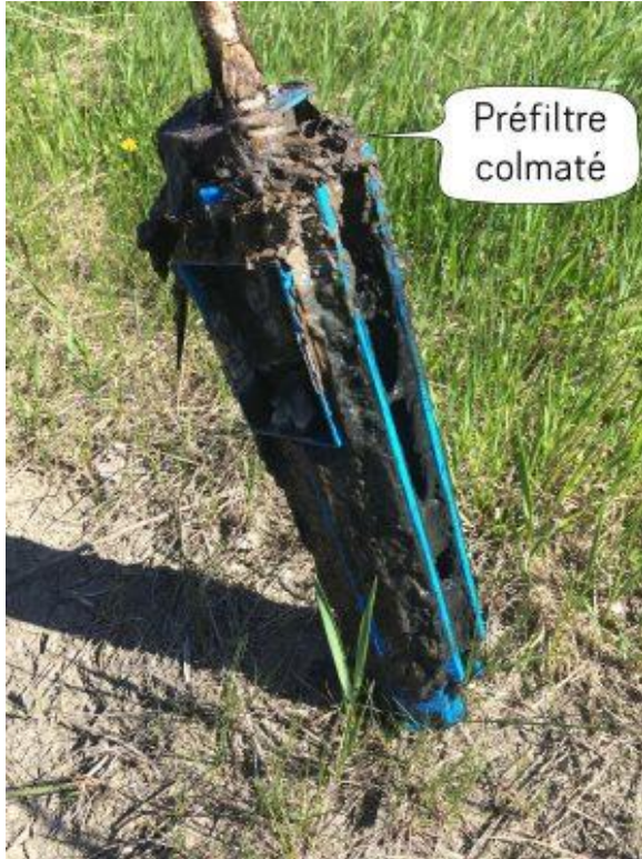
Figure 25 : Préfiltre colmaté ne laissant plus passer les eaux vers l'élément épurateur.
