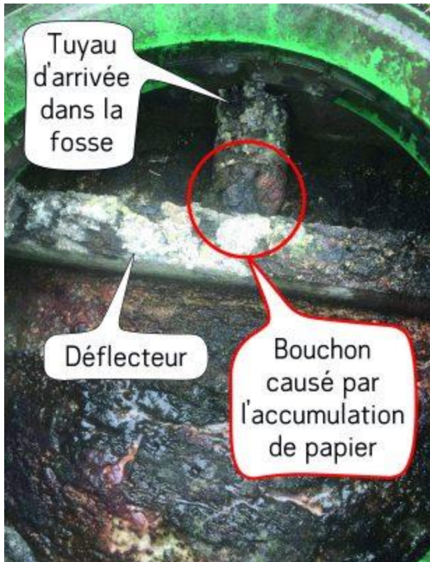
Figure 34 : Premier couvercle : bouchon causé par l'accumulation de papier au tuyau d'entrée dans la fosse.
