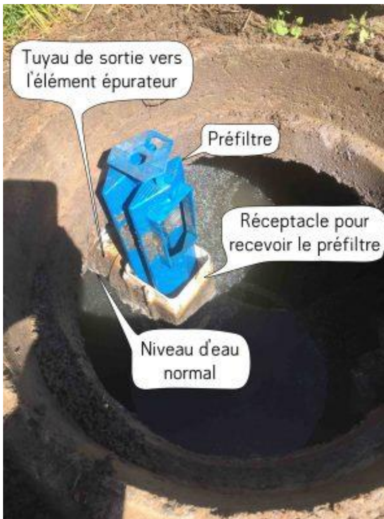
Figure 5 : Niveau d'eau normal observé dans le deuxième couvercle.
