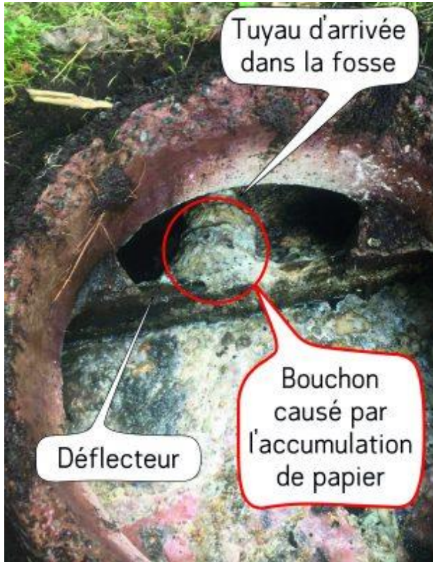
Figure 30 : Premier couvercle : bouchon causé par l'accumulation de papier au tuyau d'entrée dans la fosse.
