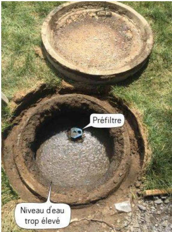
Figure 21 : Niveau d'eau trop élevé dans le deuxième couvercle, le niveau d'eau est au-dessus du tuyau de sortie vers l'élément épurateur.
