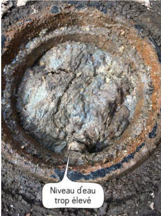
Figure 19 : Niveau d'eau trop élevé dans le premier couvercle, on ne voit ni le tuyau d'arrivée dans la fosse, ni le déflecteur.
